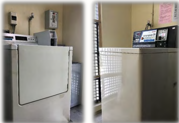
自費洗烘脫設備
